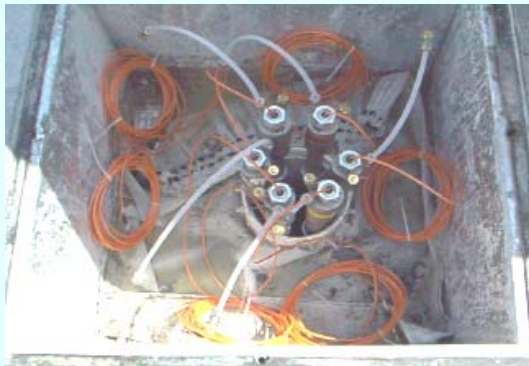
Fiber Optic 圧力変換機
